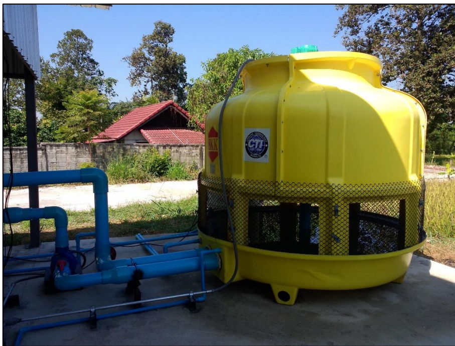
รูปที่ 5 ท่อฝั่งระบายความร้อน
