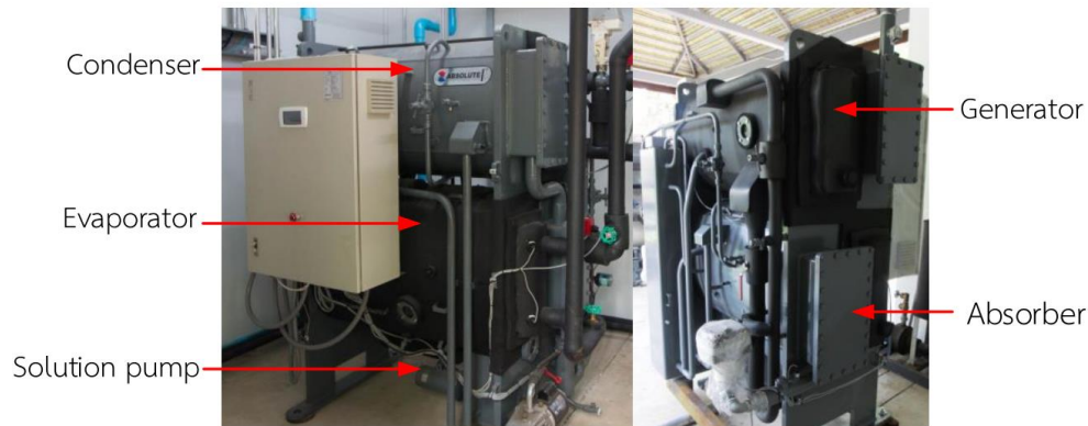
Figure 7 ระบบทำความเย็นแบบดูดกลืนขนาดการทำความเย็น 3 TR
