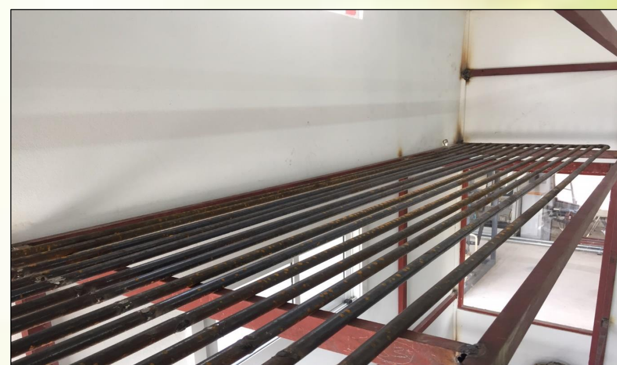
รูปที่ 5 แผงแลกเปลี่ยนความร้อน
